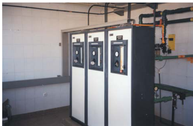
Sistema de inyectores de la dosificación de cloro gas. El control de dosificación es completamente automático.
