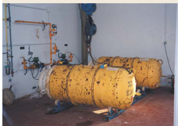
Botellones de cloro gas de un sistema de cloración. La disposición típica es una botella en funcionamiento y otra de reserva que funciona automáticamente al agotarse la primera.
