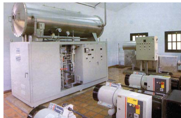
Productor de ozono de última generación de una estación potabilizadora de tamaño medio.
