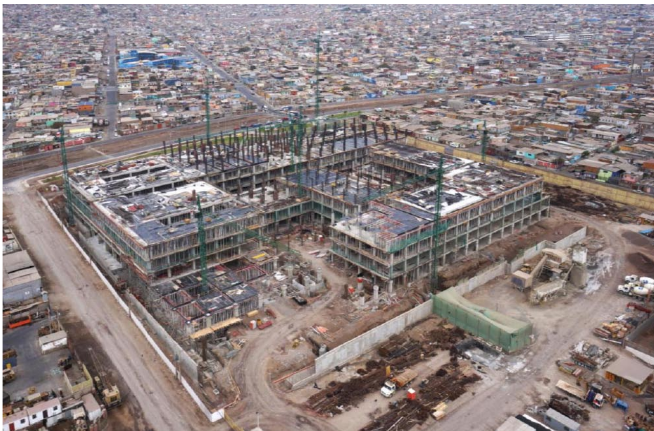
Figura 18. Mes 9 de obra donde se aprecia la esquina por donde se da acceso a la maquinaria
