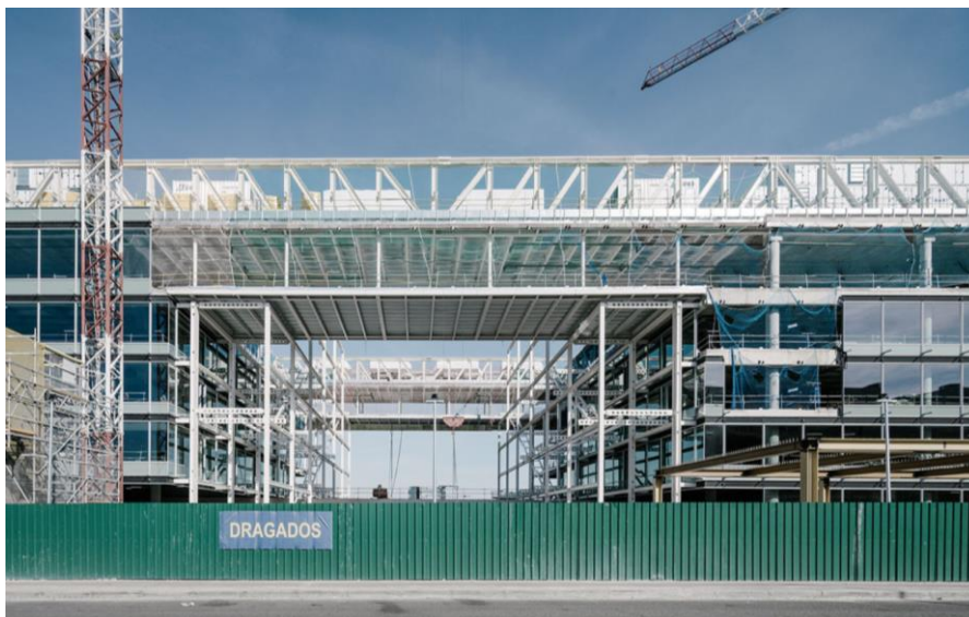
Figura 7. Puentes sur (primer plano) y norte (al fondo) entre bloques A y B, con planta cuarta suspendida
