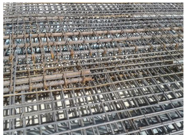
Figura 14. Detalle en obra de encuentro losa apoyada en el terreno / viga de cimentación
