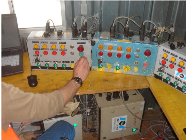
Figura 6. Unidad informatizada de control
