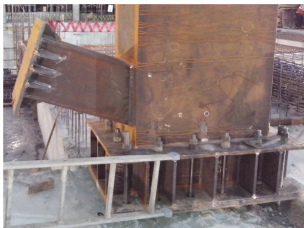
Figura 9. Conexión de arranque con anclajes expuestos
