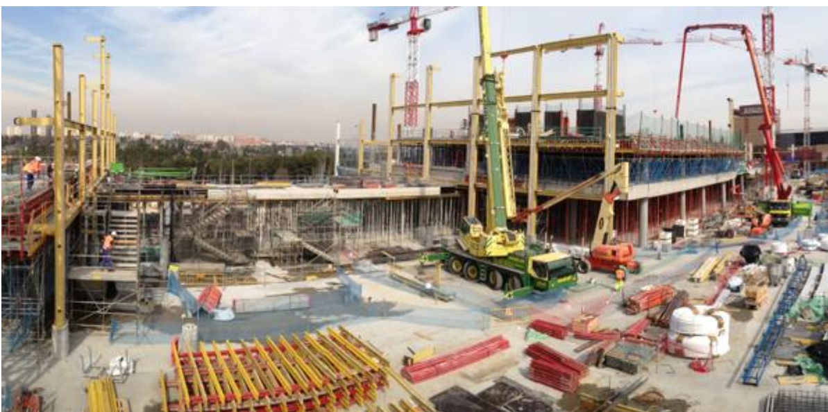
Figura 10. Acopios y maquinaria sobre forjado de planta baja.
