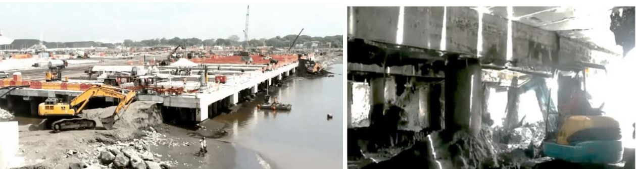
Figura 13a, 13b. Vista general del muelle durante la excavación y dragado del terraplén bajo la losa del muelle. Vista de las operaciones de excavación.
