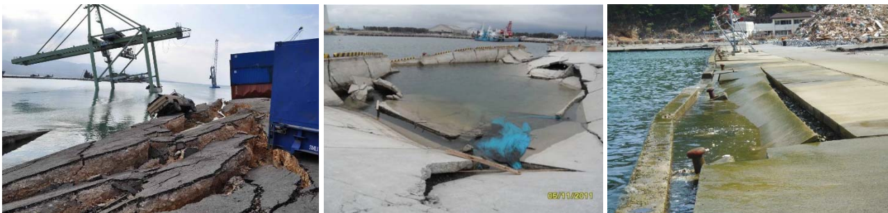
Figura 4a, 4b, 4c. Daños en el puerto de Puerto Príncipe (Haití) tras el terremoto de 2010 [6]. Daños en los puertos de Soma y Konori (Japón) tras el terremoto de Tohoku de 2011 [4].
