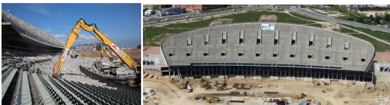
Figura 3. Trabajos de demolición del graderío bajo existente y vista con el graderío demolido
