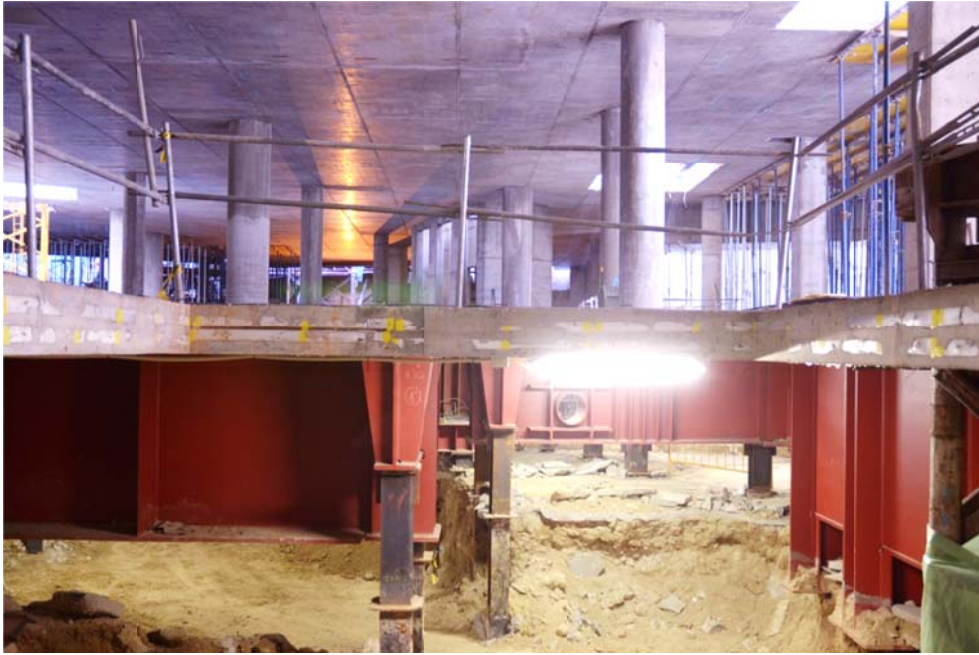
Figura 4. Imagen de la planta interfaz entre el proceso ascendente y el descendente.
