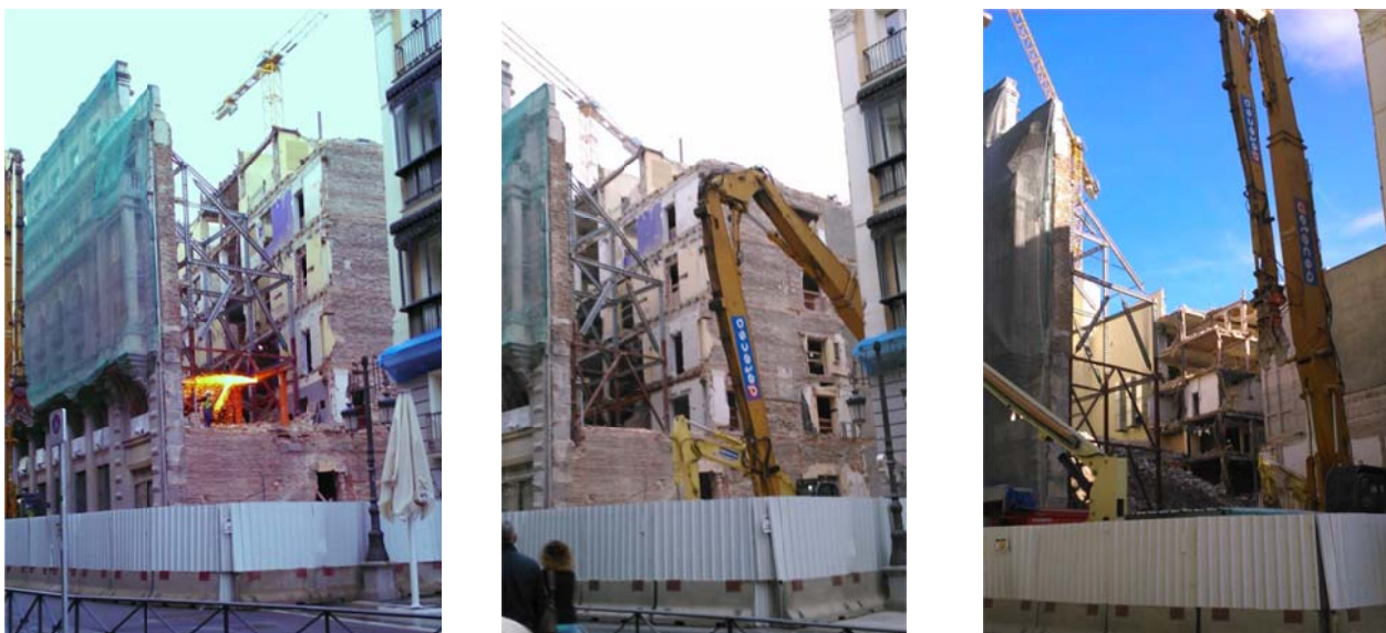
Figura 3. Vista de la demolición interior a través espacio liberado por el desmontaje de la fachada de Alcalá 6. Obsérvese la desvinculación de la estructura de la primera crujía y la demolición del interior con medios mecánicos de alta capacidad.
