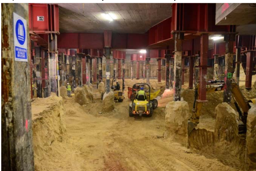
Figura 8. Vista de la excavación bajo rasante. Obsérvense en la parte superior los encepados provisionales y las vigas de transferencia asociados a la planta interfaz. En el plano medio, los soportes provisionales con el color negro de la impregnación bituminosa y los definitivos, en color rojo. La placa inferior del soporte definitivo marca la cota del forjado de sótano 2.
