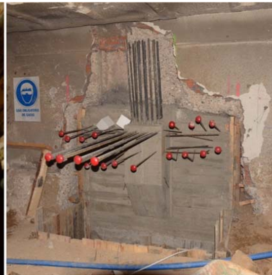
Figura 12. Batache terminado. Obsérvese la ménsula de arranque del soporte adosado a fachada
