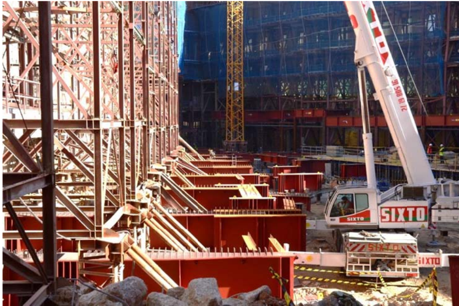
Figura 13. Vista de la colocación de las vigas cargadero perpendiculares a la fachada de Alcalá y su apoyo sobre encepados provisionales
