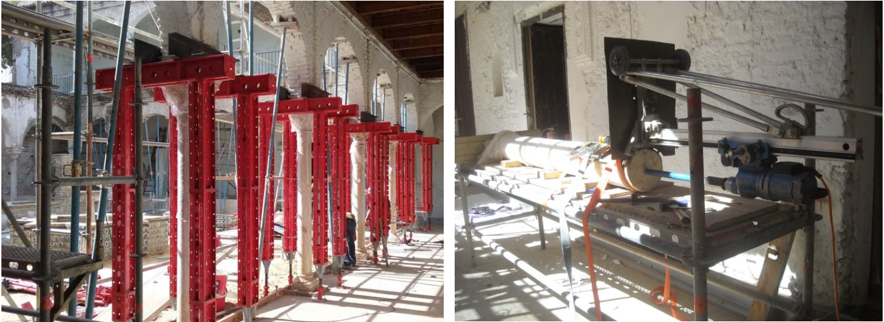
Figura 8. Estructura auxiliar de apeo y detalle de ejecución de taladro axial en columnas de mármol
