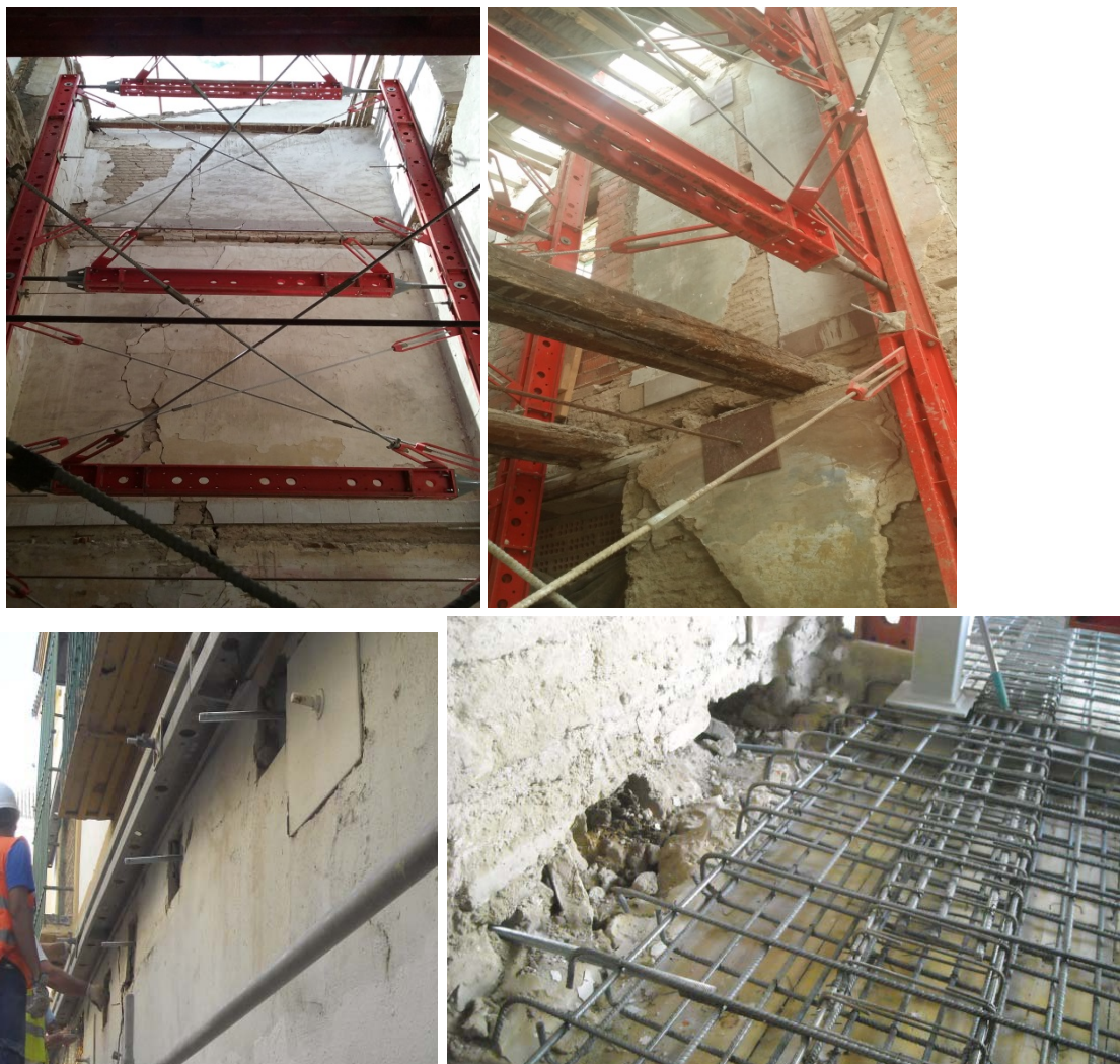
Figura 7. Estabilización de fachadas y detalle de conexión de nuevo forjado con muro existente
