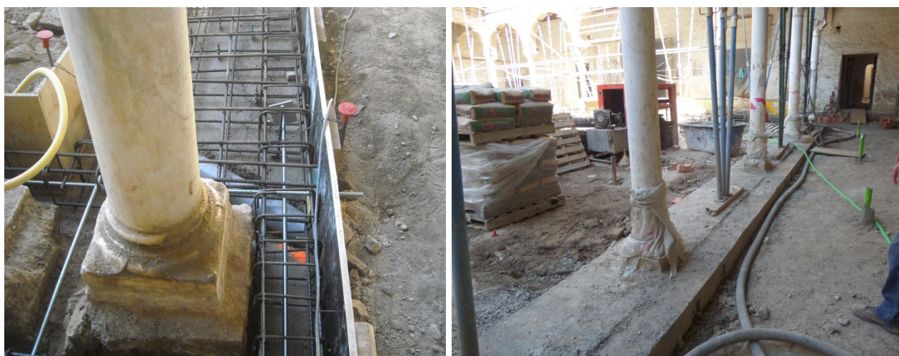
Figura 3. Viga flotante de cimentación y consolidación del terreno mediante inyecciones de impregnación
