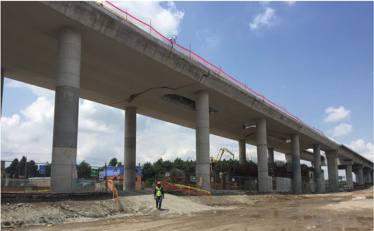
Figura 10. Tablero y pilas de la estación de Zinacantepec en fase de obra.
