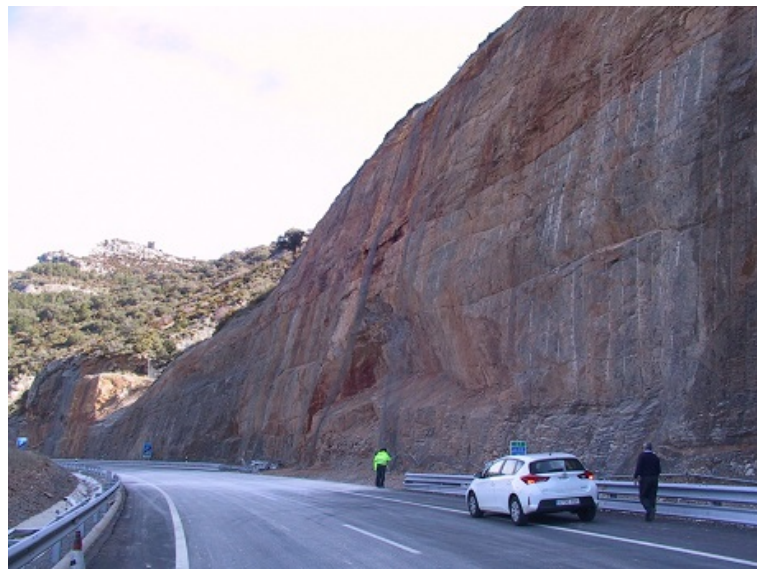
Figura 2. Vista general de la cuña tras el desprendimiento
